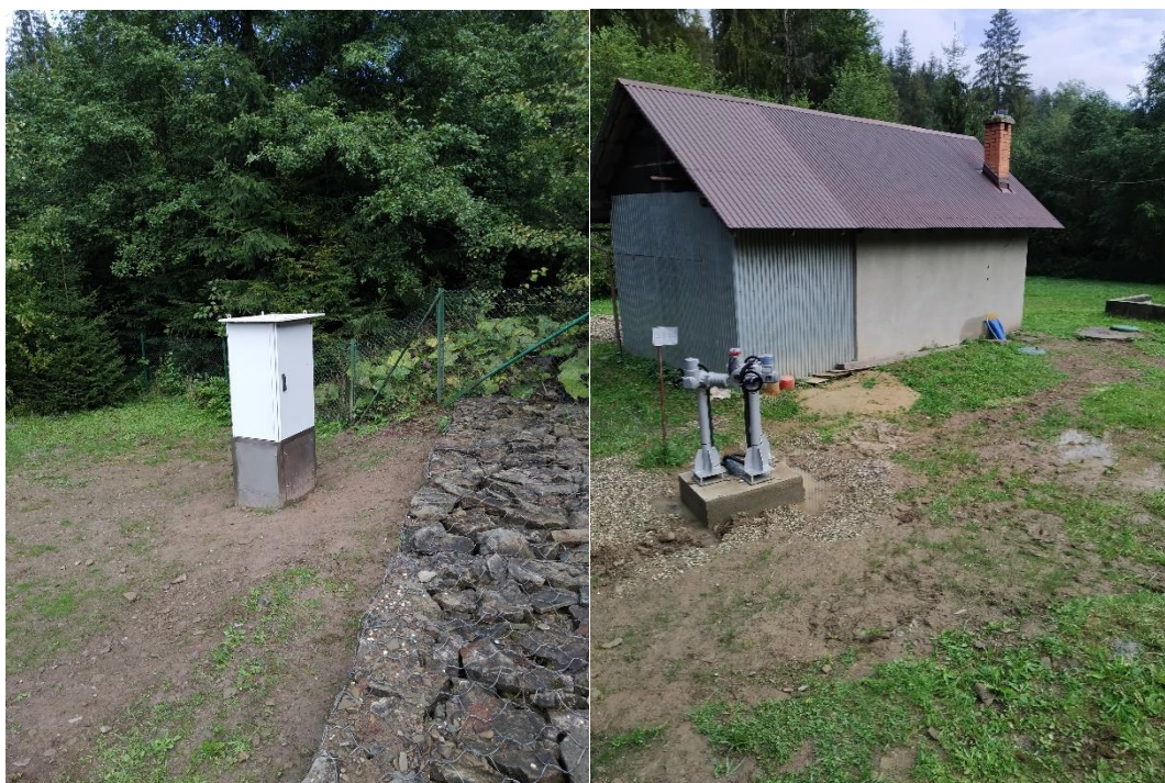
Zdjęcia: po lewej: szafa odczytująca mętności wody z potoku Krężelka, po prawej: system automatycznych zasuw.
