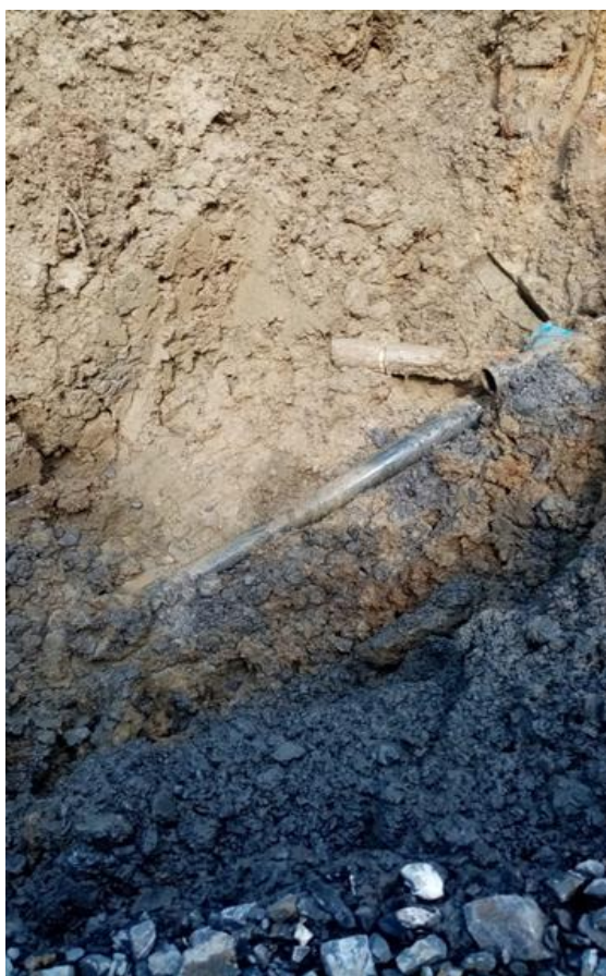
Zdjęcie 3 Awaria wodociągu Istebna Matyska.
