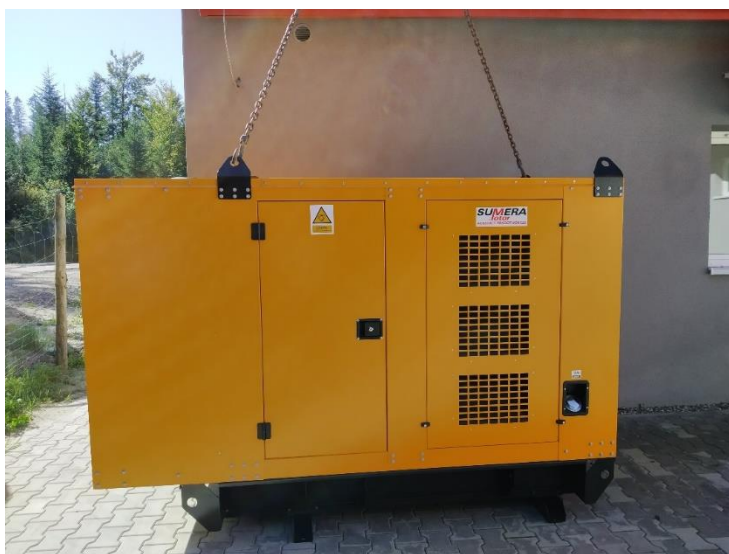
Zdjęcie 9 Agregat prądotwórczy na oczyszczalni Koniaków Pustki.
