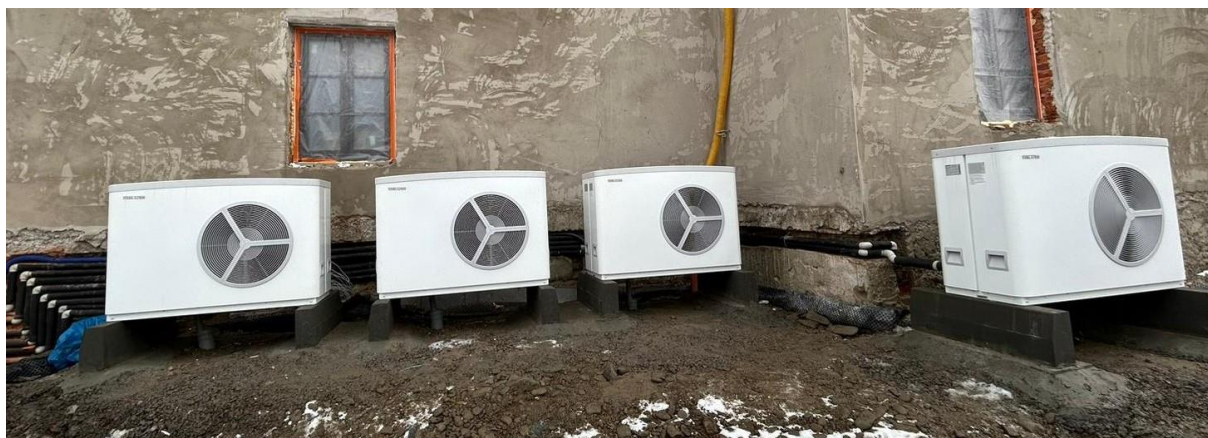
Zdjęcie 42 System ekologicznych pomp ciepła zamontowany w budynku GOK.
