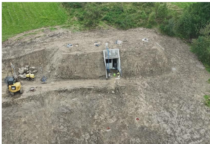
Zdjęcie 21 Zbiornik wody na Wawrzaczowym Groniu.
