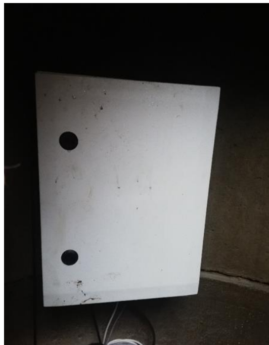
Zdjęcie 6 Szafa telemetryczna wewnątrz studni wodomierzowej - Istebna Centrum.
