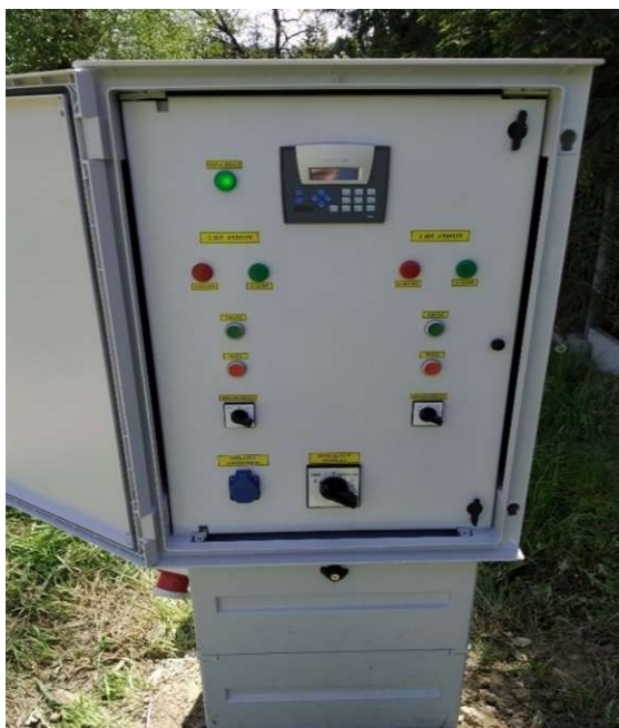
Zdjęcie 3 Nowa szafa sterownicza przepompowni ścieków Istebna Żor
