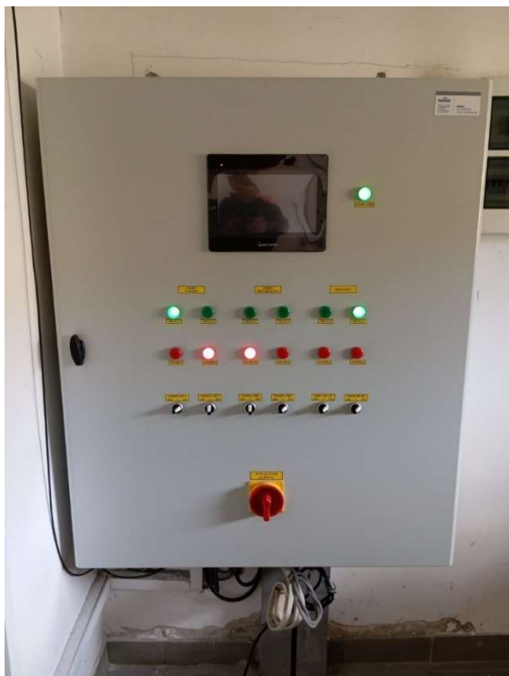
Zdjęcie 7 Nowa szafa sterownicza na oczyszczalni ścieków Jaworzynka Czadeczka.
