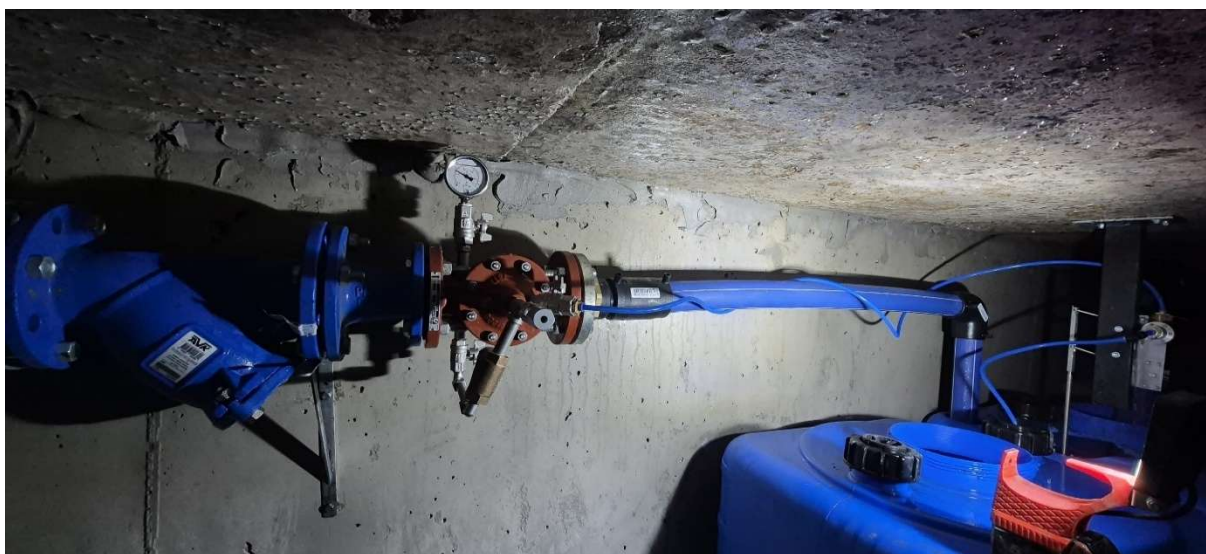
Zdjęcie 4 Armatura wodociągowa wewnątrz studni redukcyjnej – Jaworzynka Kopanice.
