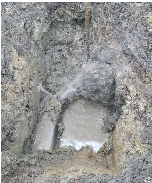
Zdjęcie 1 Awaria sieci wodociągowej w rejonie Jaworzynka Bestwiny.
