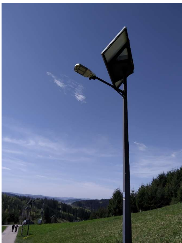
Zdjęcie 8 Oświetlenie typu „Bocian”. Widok całej lamp.
